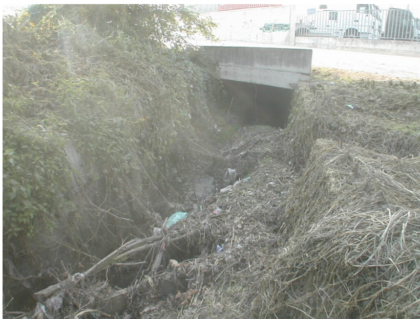
Il Cavo Biocco nella zona artigianale a nord della strada per Borgosatollo.
